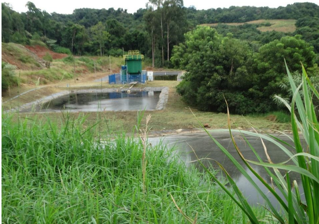
Figura 23: Visão geral do sistema de tratamento do líquido percolado.
