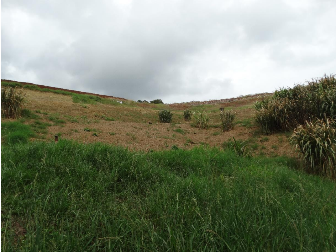
Figura 20: Ausência de sistema de drenagem.
