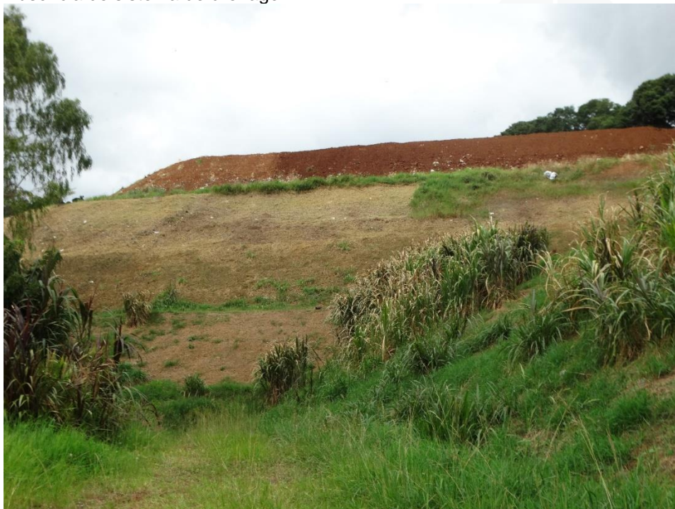
Figura 18: Ausência de sistema de drenagem.
