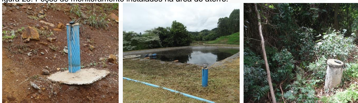
Figura 25: Poços de monitoramento instalados na área do aterro.
